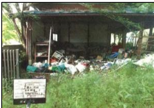
老朽化した建物及び残置された動産
