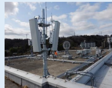
5G基地局/合同宿舍屋上 (仙台市)
