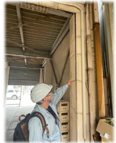
被害状況の確認
