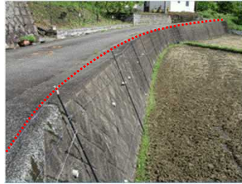
柵の高さが法面と同程度しかなく侵入防止効果がない箇所
