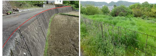
柵の高さが法面と同程度しかなく 草刈りが行われていない箇所 侵入防止効果がない箇所
