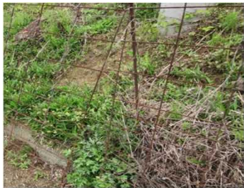
柵の接地面への固定が不十分な箇所
