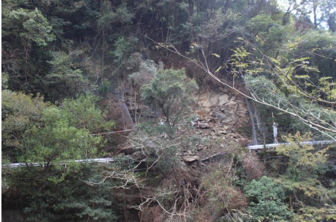
令和4年台風第14号：高知県吾川郡仁淀川町 町道森川渡線（提供：仁淀川町）
