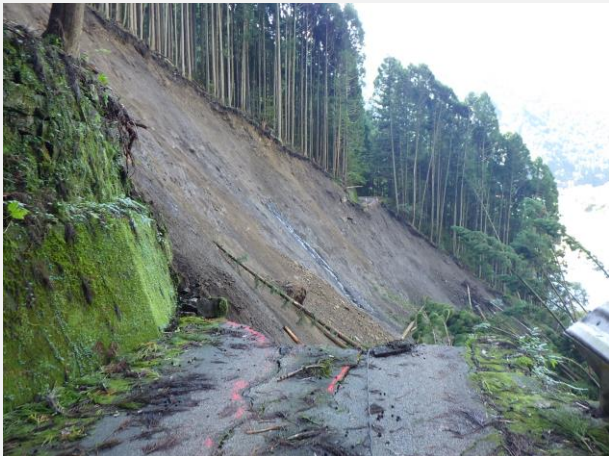
令和4年台風第14号：高知県香美市 市道大板河口線（提供：香美市）
