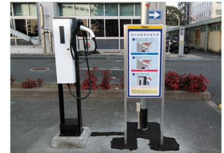
EV用充電器 / 福岡地方合同庁舎 (写真提供元：タイムズ24株式会社)
