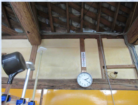
【梁の高さまで浸水したことを示す水面の跡】
