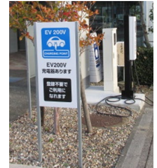
【駐車場敷地内EV充電器】
