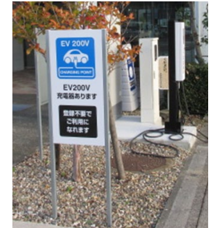
【駐車場敷地内EV充電器】
