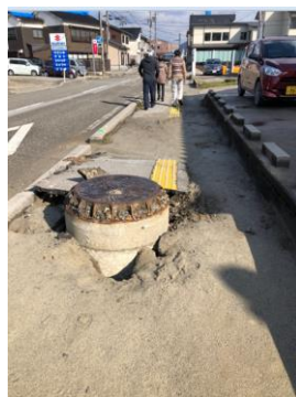
(輪島市内の被災状況)
