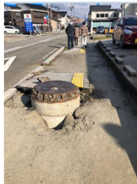
輪島市内の被災状況
