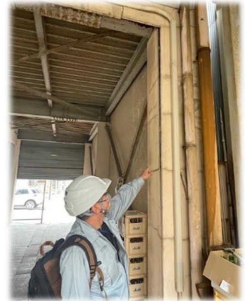
被害状況の確認
