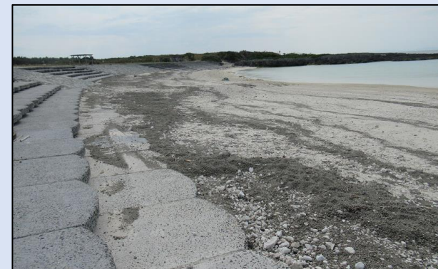
【被災後のスギラビーチ】
