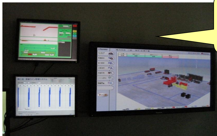
設備管理システム
