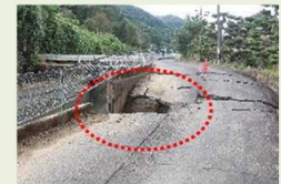
（八代市：農業用水路の崩壊）
