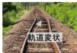
（肥薩おれんじ鉄道線：軌道変状）
