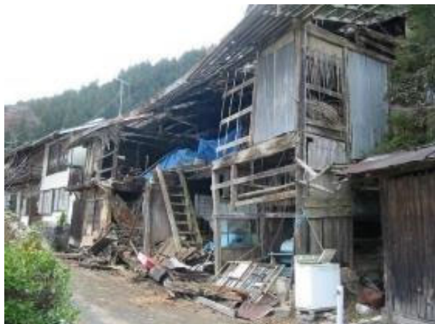
倒壊のおそれのある空き家
