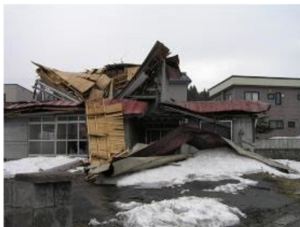
積雪により屋根が落下した空き家
