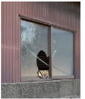
窓が割れた管理不全空家
