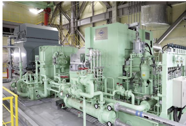
蒸気タービン発電機
