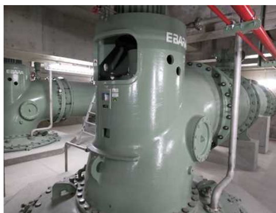
大谷川雨水ポンプ場(立軸斜流ポンプ)
