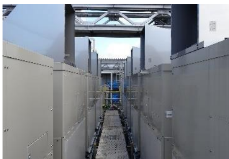
バイオマス発電設備
