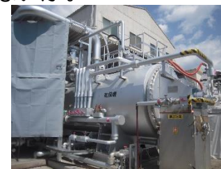
汚泥乾燥設備
