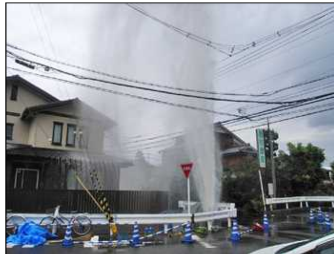
2014.9.3 京都市水道管破裂
