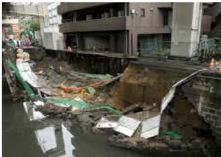
2013.10.15 東京都港区区道崩落
