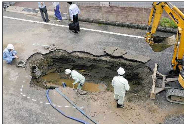
2014.8.5 大分市道陥没
