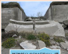
基礎部分の砂が流出し構造物が崩落。崩落の衝撃で亀裂が生じている。
