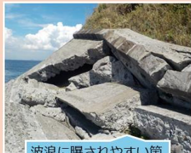
波浪に曝されやすい箇所の被覆コンクリートが崩壊。
