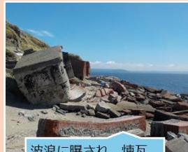
波浪に曝され、煉瓦積みの砲座は崩壊し、散乱している。
