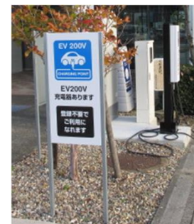
駐車場敷地内EV充電器
