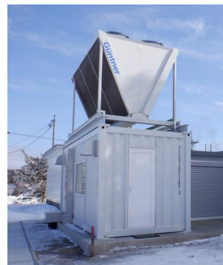
バイナリー発電設備（弟子屈町）
