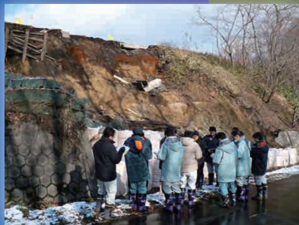
◆災害査定立会の様子
