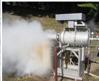
＜湯けむり発電システム＞
