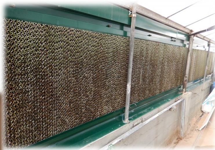
実験施設ではパッドファン方式の冷房設備を備えていた。
