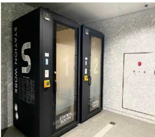
※さいたま新都心合同庁舎における設置例
