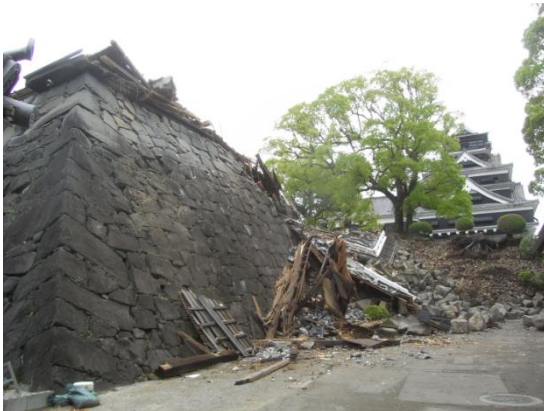
【 熊本城の被災状況 】
